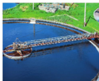
> Station de traitement des eaux usées
